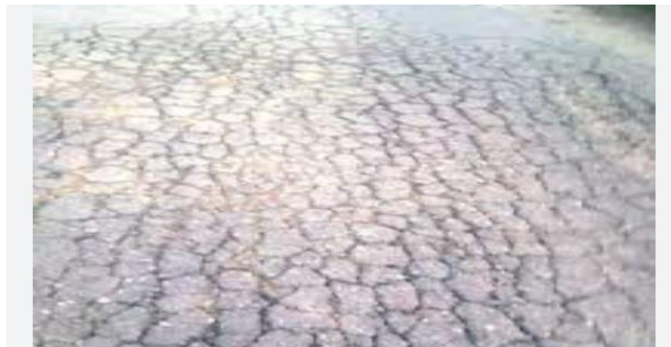
Gambar 2. 3 Retak Kulit Buaya ( Alligator Cracking )
